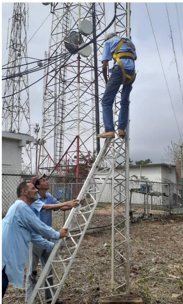
Figura 5. Instalación de equipos donados por la Sección de Estudios Venezolanos
